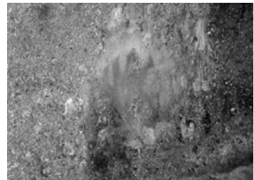
写真-8 10ヵ月後の状況
