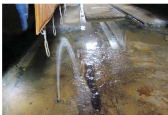
写真-9 場所打ち洞道 漏水箇所
