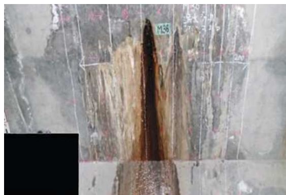
写真-8 場所打ち洞道 漏水箇所
