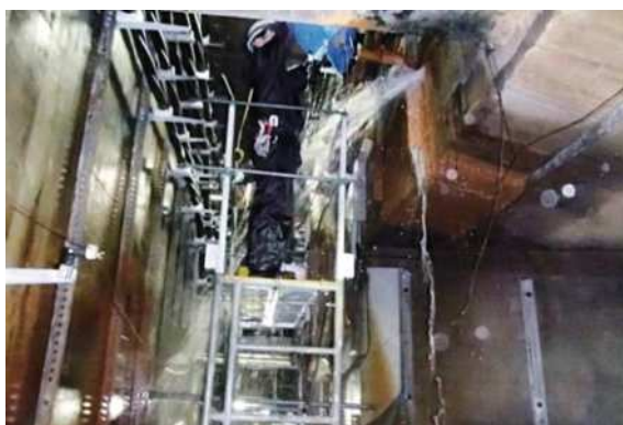
写真-6 多量漏水箇所 (最大漏水箇所 約200 l/min)
