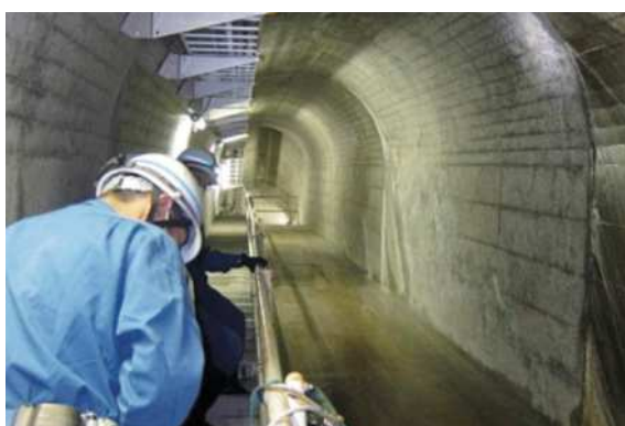
写真-7 ダム監査廊 漏水状況
