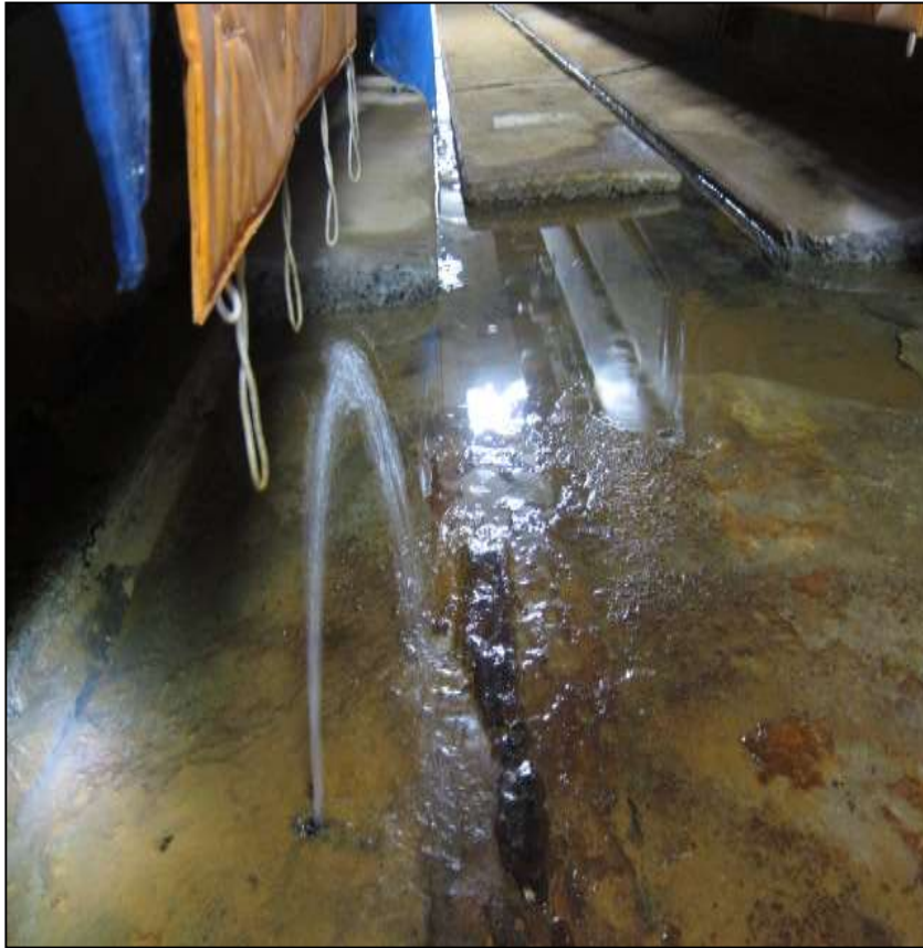
電力洞道漏水状況 都市NATM
