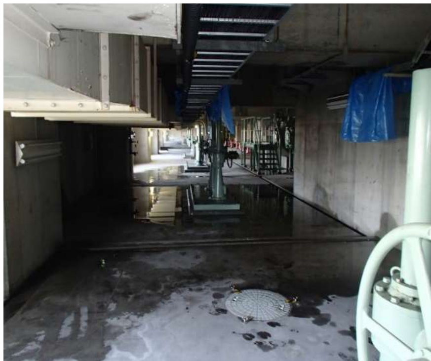
施工前：漏水状況 (平成29年11月時点)
