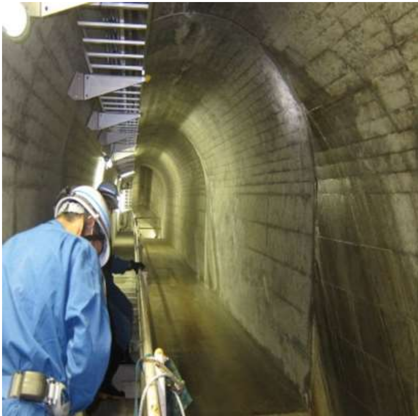
2013年4月(施工前) 漏水量 12リッター/分
