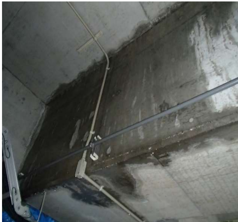
施工前：漏水状況 (平成29年11月時点)
